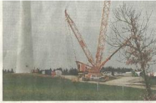
Für die Montage müssen Windgeschwindigkeiten von nicht mehr als sechs Metern in der Stunde herrschen.
